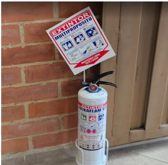
Bodega Central / Inadecuada Señalización, se utiliza el extintor para sostener la apertura de la puerta del tercer piso
